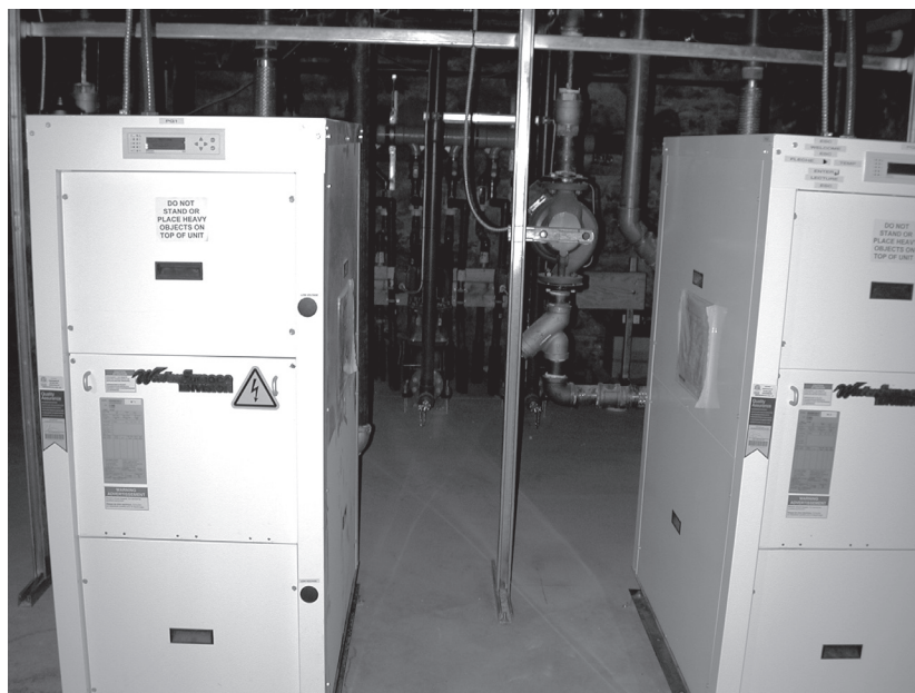
Ici, les deux thermopompes qui ont été installés dans la zone des machines au sous-sol de la sacristie.
